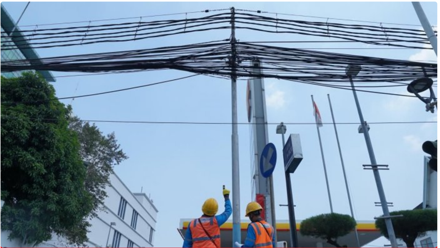
Photo: Titik Lokasi pencuri Kabel PLN
